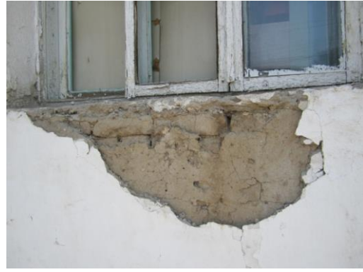
Отслоение штукатурки подоконных стен, полный износ оконных рам
