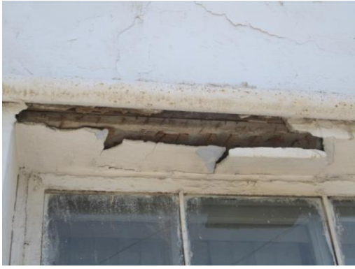
В перемычках оконных проемов сквозные трещины
