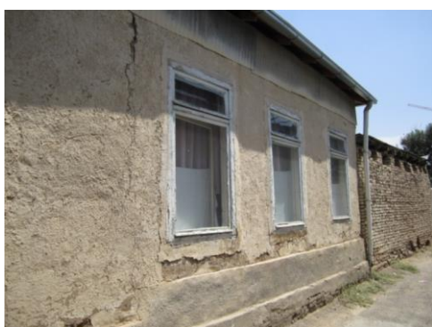
Вертикальные трещины, осыпалась штукатурка и частичное разрушение цокольной части снаружи стен
