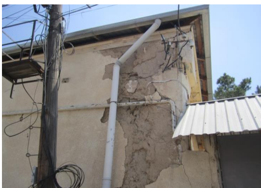
В наружных стенах отслоение штукатурки большими кусками
