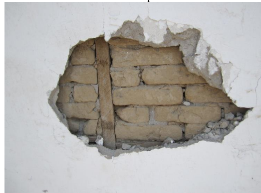
Отслоение штукатурки, деревянный каркас с заполнением из сырцового кирпича
