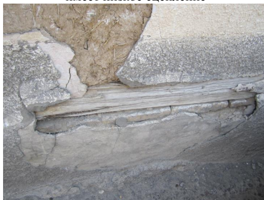
Фрагмент разрушения цокольной части здания основного блока
