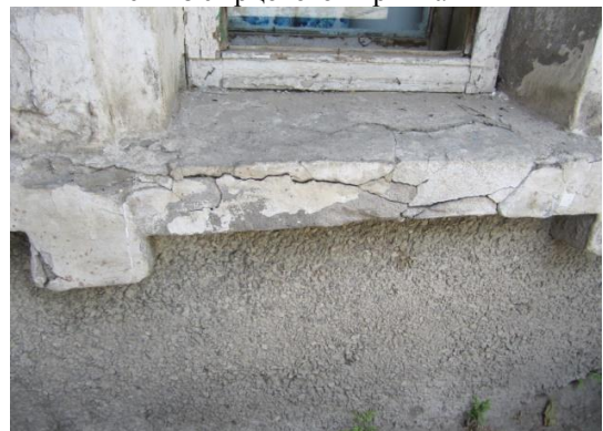
Трещины в кирпичной кладке оконного проема
