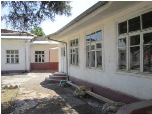
Отмостка зданий изношена, что привело к разрушению покрытия дворовой площадки
